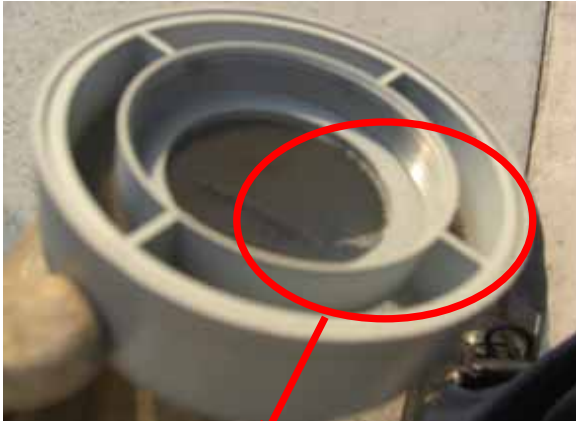
通気網が破損しています。
