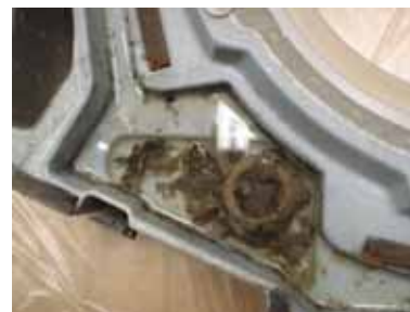
写真 1. ドレンパン上に発生したドレン水・スライム
