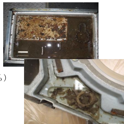
写真 1. ドレンパン上に発生したドレン水・スライム
