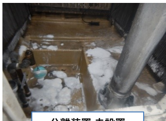
分離装置 未設置
