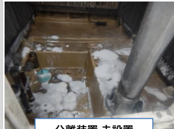
分離装置 未設置
