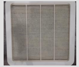
【対策フィルター取付後】
